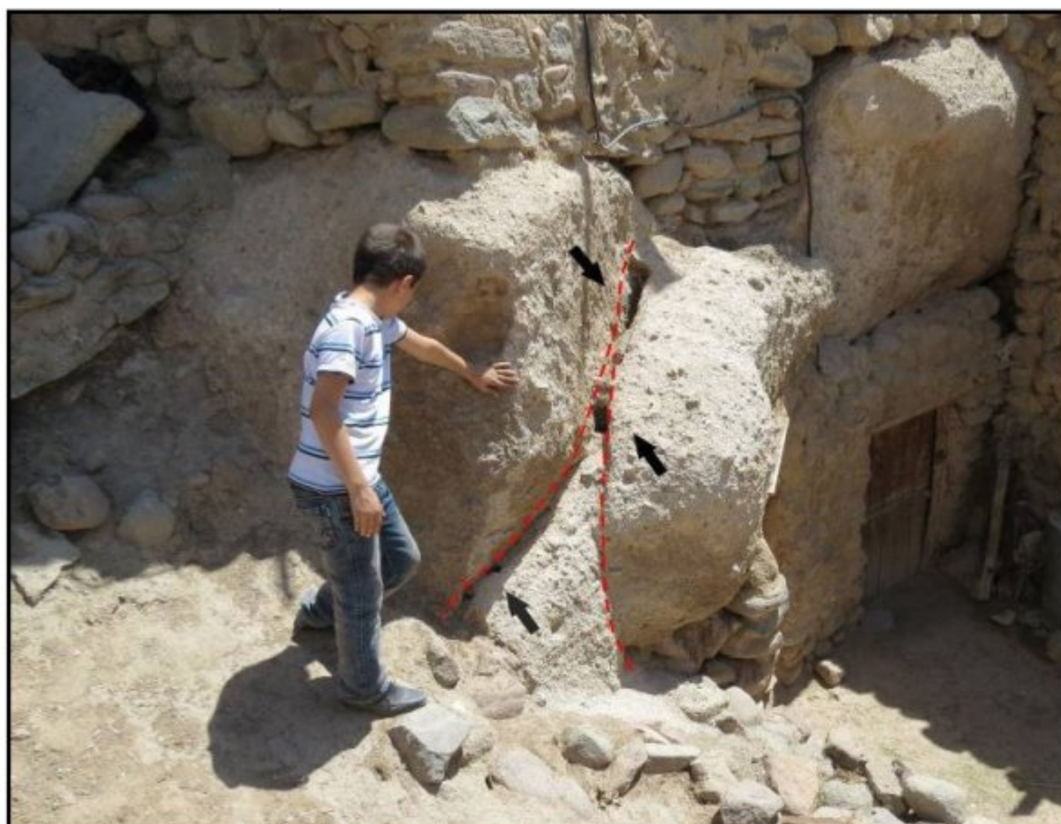
تصویر ۵: نفوذ آب در امتداد شکستگی‌ها به داخل توده سنگ
